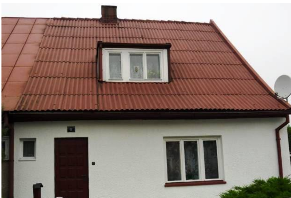
Rys. 6. Pokrycie dachowe ocenione w III stopniu pilności.
