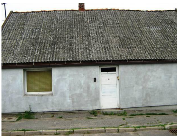
Rys. 7. Pokrycie dachowe ocenione w II stopniu pilności.
