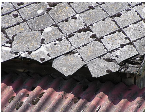
Rys. 8. Pokrycie dachowe ocenione w I stopniu pilności.
